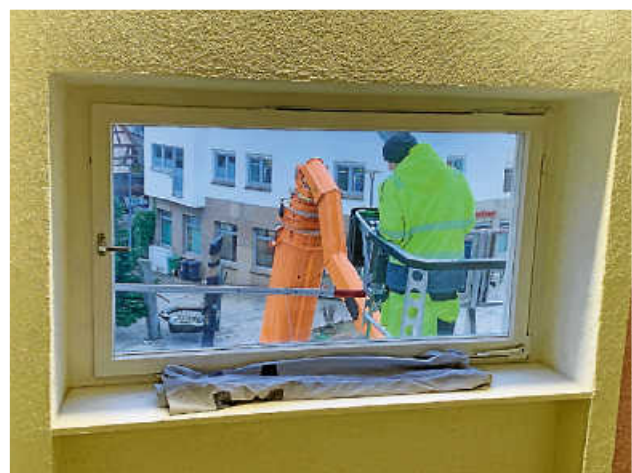
Ungewohnter Ausblick: noch vor Weihnachten kontrollieren Männer mit dem Steigerwagen die Schäden am Vordach des Heimatmuseums. Fotos: Susanne Kittelberger
